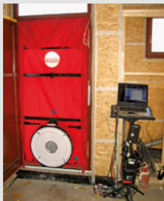
Test vzduchotěsnosti domu (tzv. blower-door test). Při testu vzduchotěsnosti se ventilátorem vytvoří v domě podtlak (a následně přetlak), díky kterému je možné měřit průnik vzduchu netěsnostmi a stanovit tak celkovou míru vzduchotěsnosti domu (Petr Matějka).
