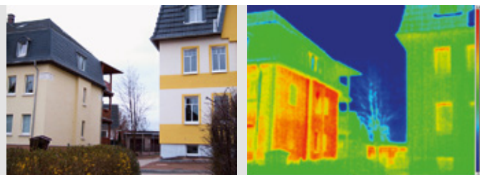
Standardní snímek a snímek z termovizní kamery. Kvalitu provedení tepelných izolací lze kontrolovat infračerveným snímkem infračervenou (termovizní) kamerou (M. Taube, www.pasivnidomy.cz )
