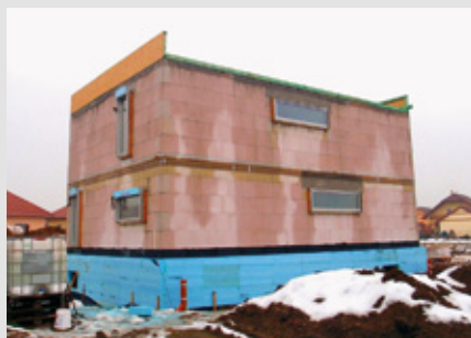
Připravená atika z OSB desek na železobetonové střešní desce pasivního domu (Kalksandstein CZ s.r.o.)
